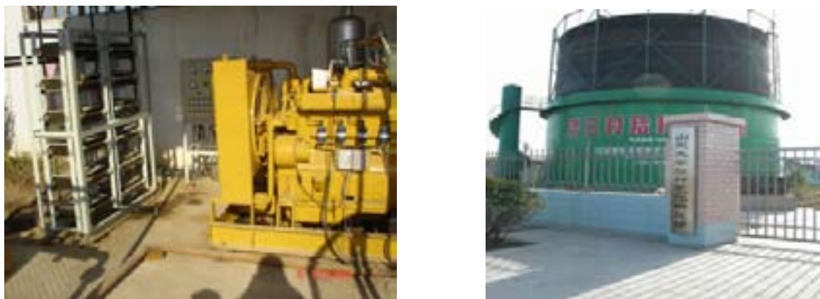
图 2 山东大学完成的济南沙三40kW秸秆气发电机组示范项目
