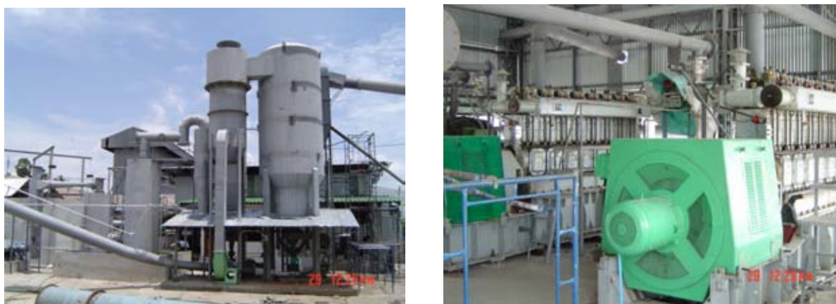
图4 黑龙江佳木斯九零米业有限公司厂区及2×400kW发电机组项目
