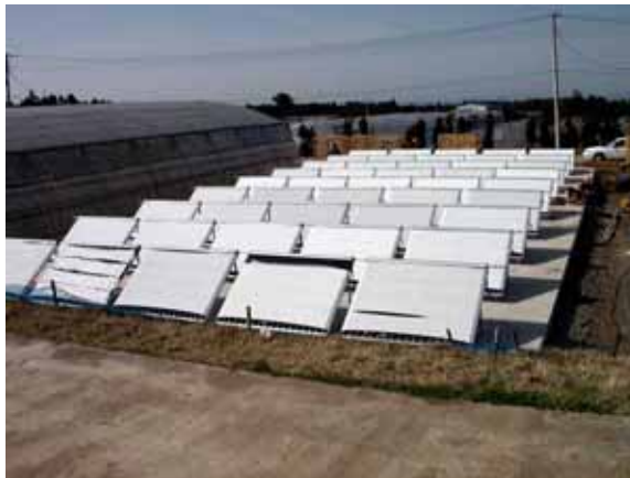
▲ Saisonale Wärmespeicherung, teilweise für Prozesswärme in Cheju-Insel, Korea
