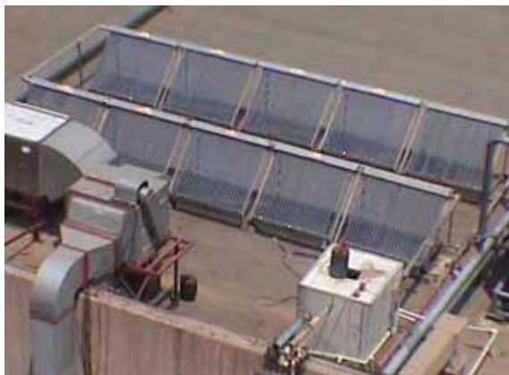
◀ Zehn Thermosiphonkollektoren in Reihe
